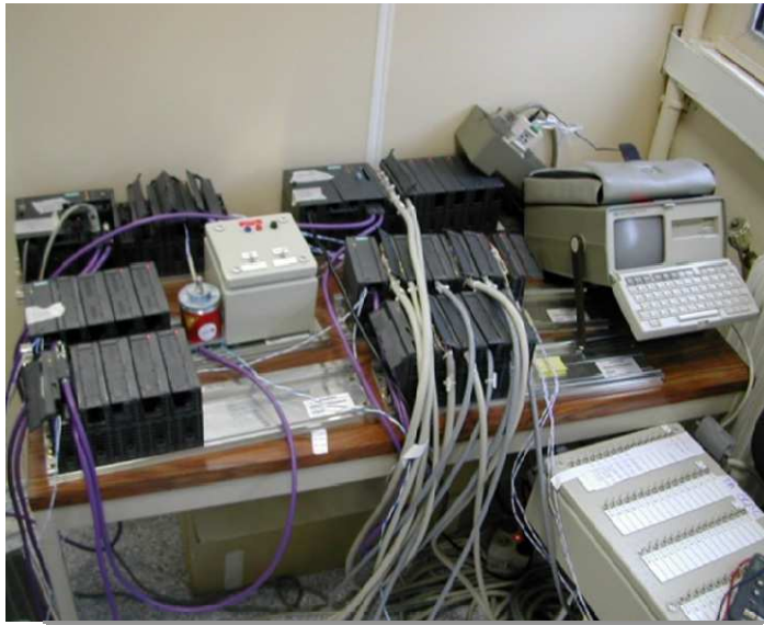
Fig. 19. PLC Input /Output Module
